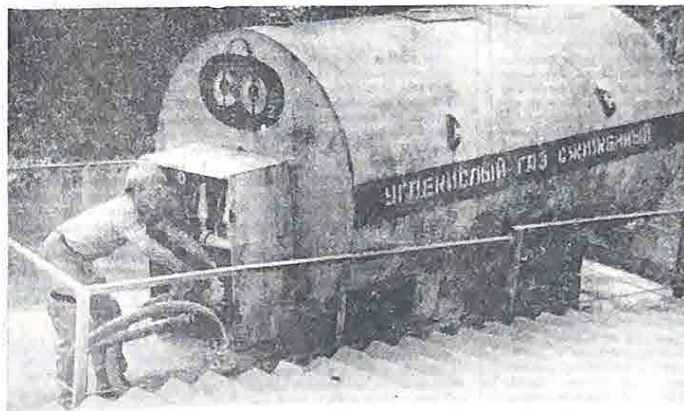
В ремонтно-механическом цехе действует установка для централизованной переоздки и хранения технической углекислоты, необходимой для питейного производства. Это позволило отказать от баллонной поставки дефицитной пищевой углекислоты.
